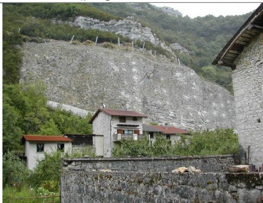
Filets de protection – Cerdon
